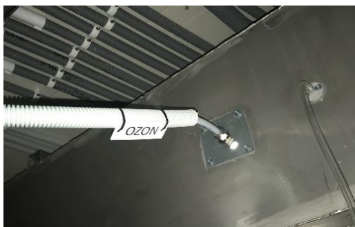
Fig. 3: markering av slang som distribuerar ozon till imkanalen
