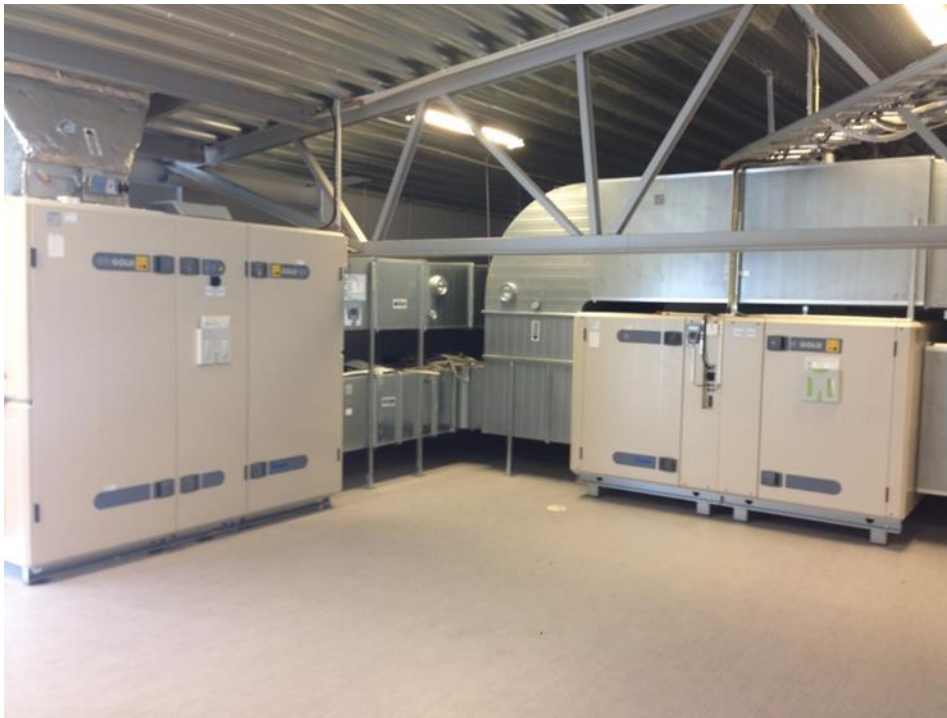
Figur 6. Bild över ventilationsaggregatets utformning, fläktrummet i Åkersberga.
