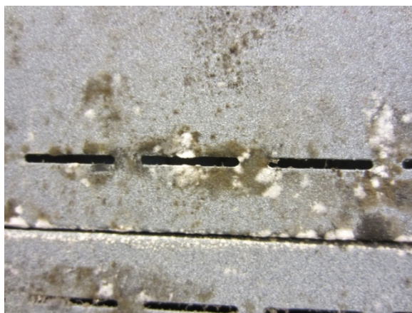
Figur 8. Kylmöbel KA1 före tvätt, påväxt på ryggplåt.
