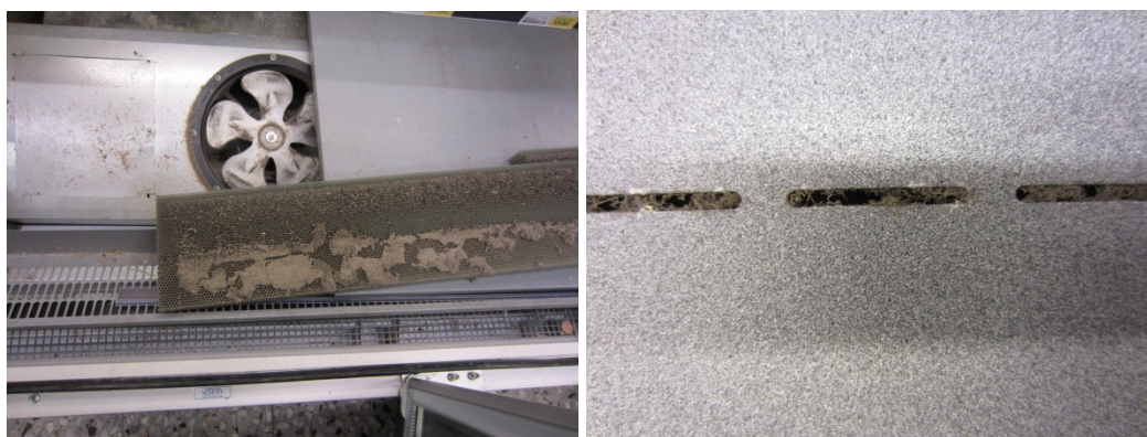
Figur 7. Kylmöbel KA1 före tvätt. Fläkt och bikupor för utblåsluften till disk i bild till vänster samt hål i ryggplåt i bild till höger.
